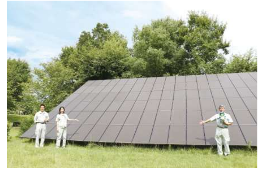
環境コミュニケーションセンターに 設置した太陽光パネル
