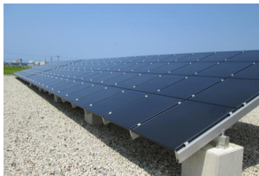
須崎ナカタケ発電所
