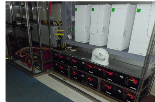
オフグリッド設備
