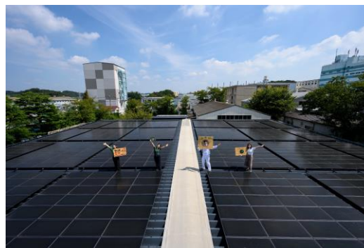
太陽光パネル
