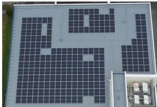
太陽光パネル
