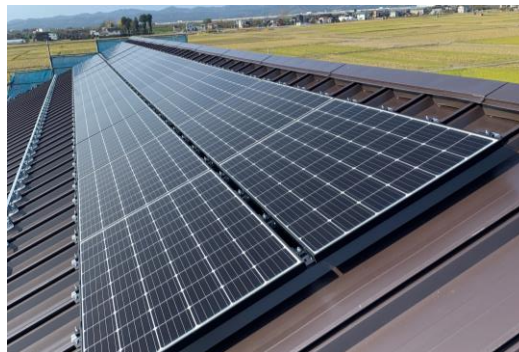
本社事務所太陽光パネル
