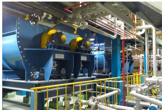
再生燃料（RF製造）プラント
