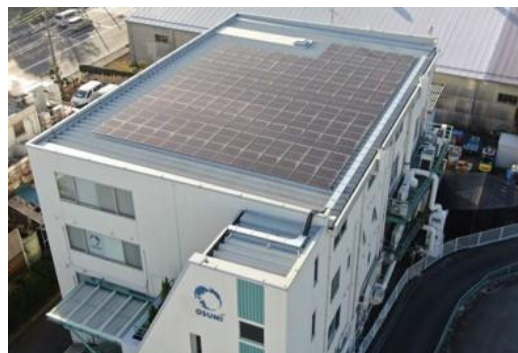
本社屋上の太陽光パネル
