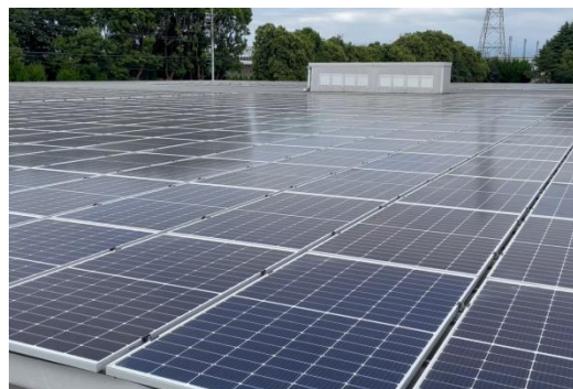
太陽光パネル
