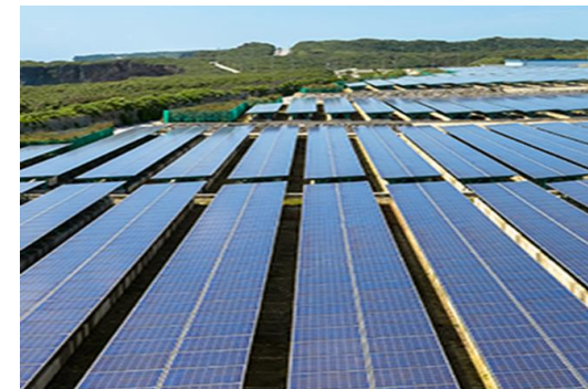
太陽光発電（鹿児島発電所）
