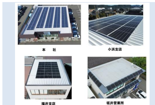
各支店 太陽光パネル
