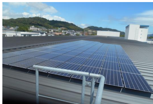
オフグリッド用太陽光発電設備
