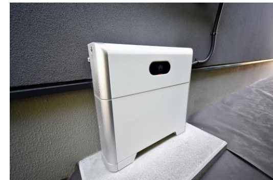
蓄電池の設置
