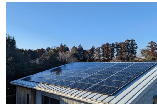
PV出力13.2kW、発電量16MWh/年
