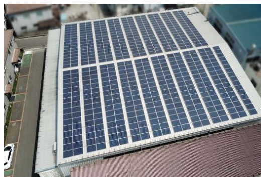
海老名工場 太陽光パネル
