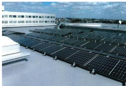
屋上に設置している太陽光パネル
