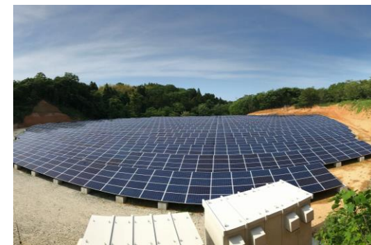
加賀第2ナカタケ発電所
