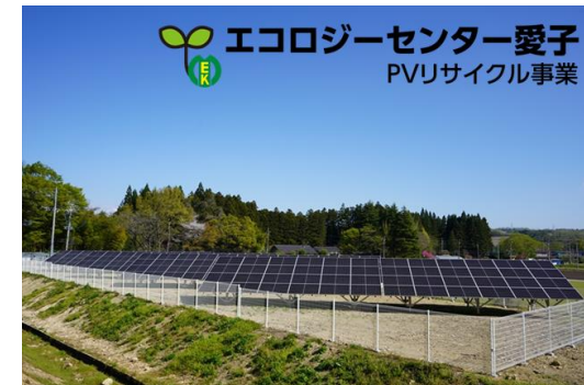
太陽光パネルリサイクル施設太陽光設備 (発電77.76kW、蓄電10kWh)
