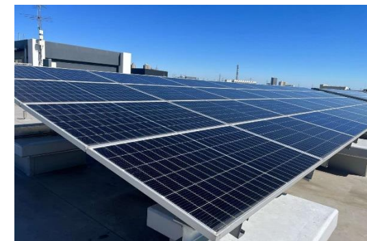
太陽光発電設備
