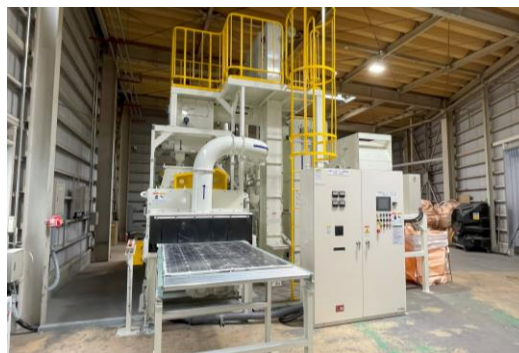
太陽光パネルリサイクル設備
