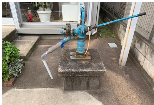
社屋前地中熱交換井・災害用井
