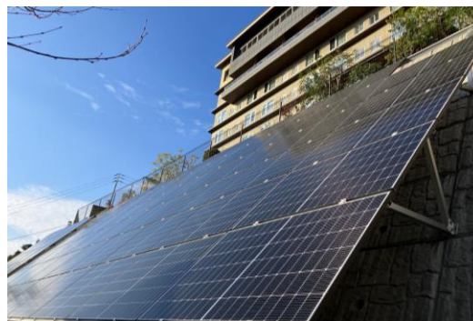
太陽光発電システム
