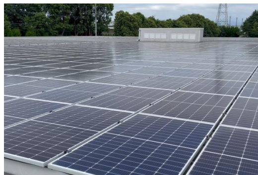
太陽光パネル
