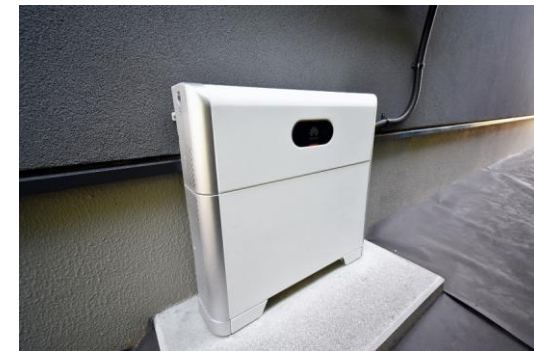
蓄電池の設置
