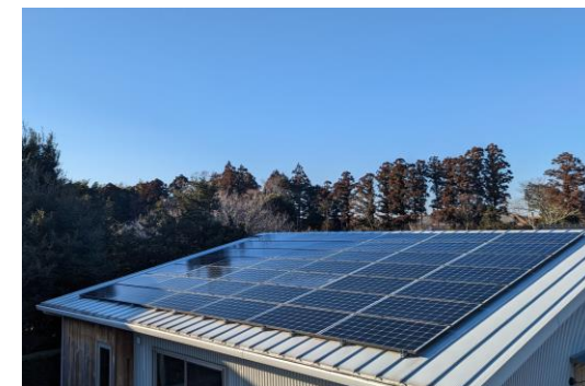
PV出力13.2kW、発電量16MWh/年
