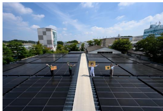
本社工場屋根に設置の太陽光パネル
