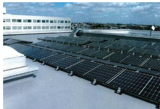
屋上に設置している太陽光パネル
