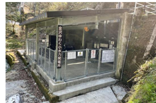
金沢ゆわく小水力発電所
