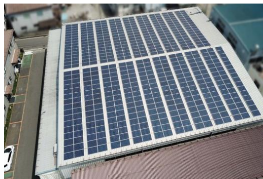
海老名工場 太陽光パネル
