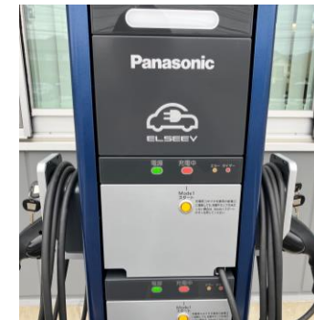
EV自動車用の給電スタンドを設置
