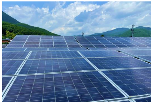
太陽光発電所（栃木市）
