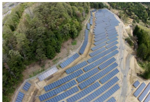
太陽光発電設備（福島県）
