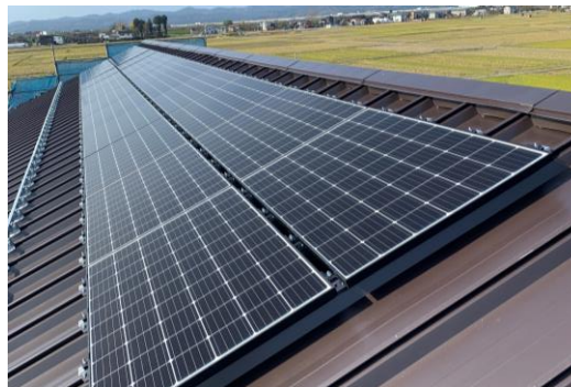
本社事務所太陽光パネル
