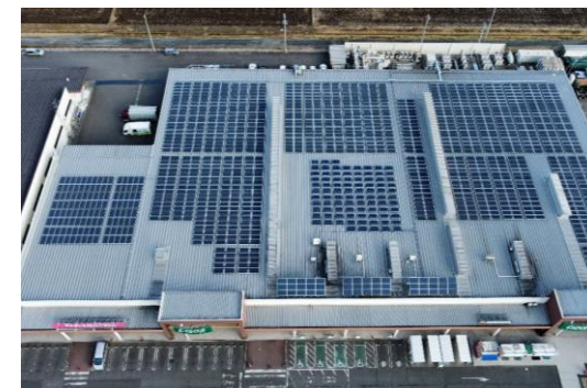
店舗屋根上の太陽光パネル
