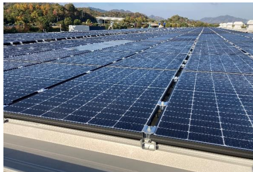
自家消費型太陽光発電設備
