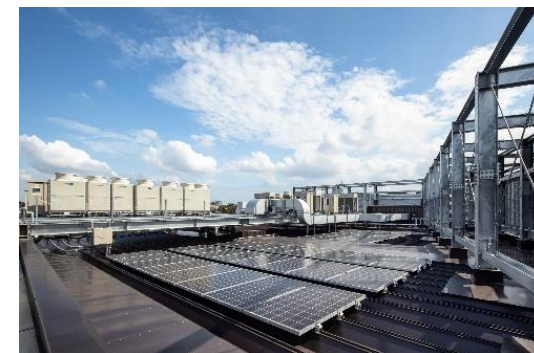
商業施設屋上の太陽光パネル
