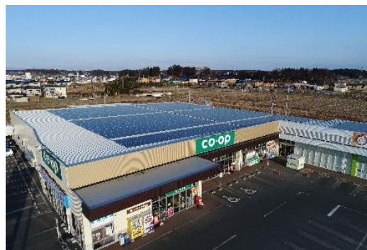
おいらせ店屋根上太陽光パネル
