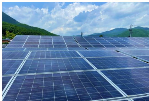
太陽光発電所（栃木市）
