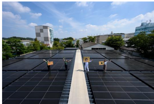
太陽光パネル
