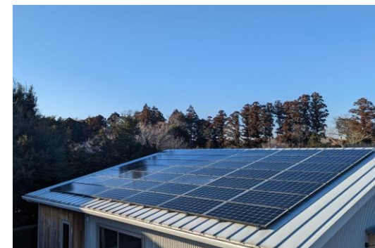
PV出力13.2kW、発電量16MWh/年
