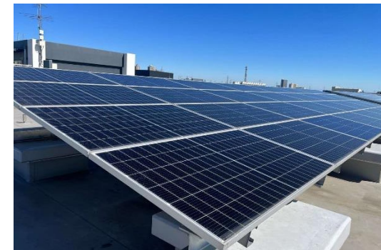
太陽光発電設備
