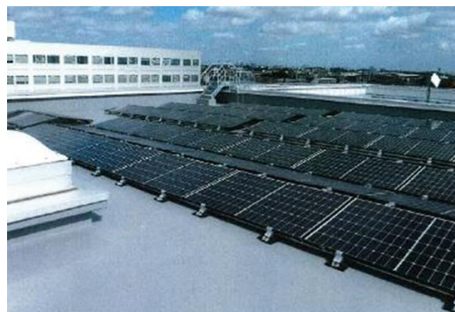
屋上に設置している太陽光パネル
