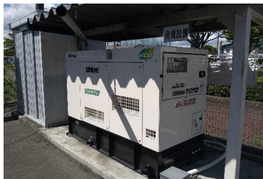
バイオディーゼルで稼働する発電機
