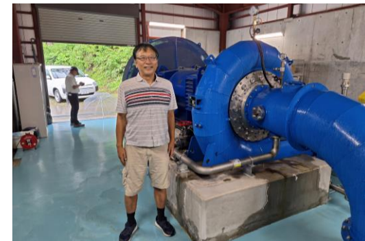
安房谷水力発電所訪問
