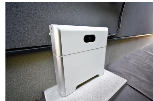
蓄電池の設置
