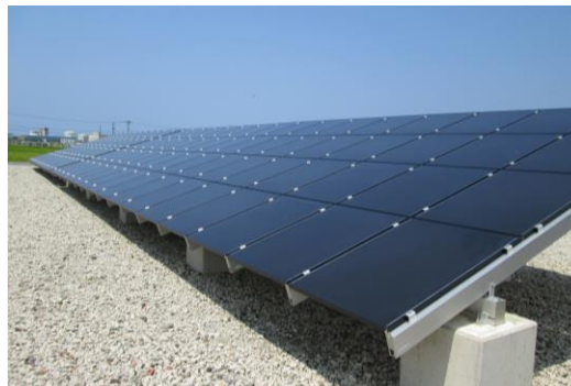
須崎ナカタケ発電所
