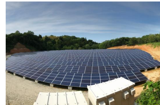
加賀第2ナカタケ発電所
