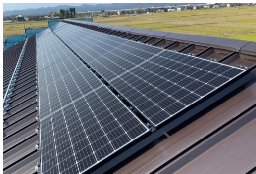
本社事務所太陽光パネル
