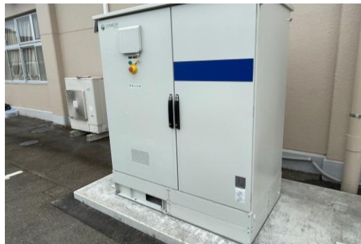
大容量蓄電池
