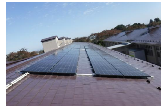
太陽光パネル
