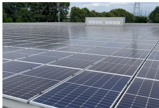
太陽光パネル
