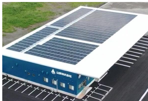
太陽光発電設備
