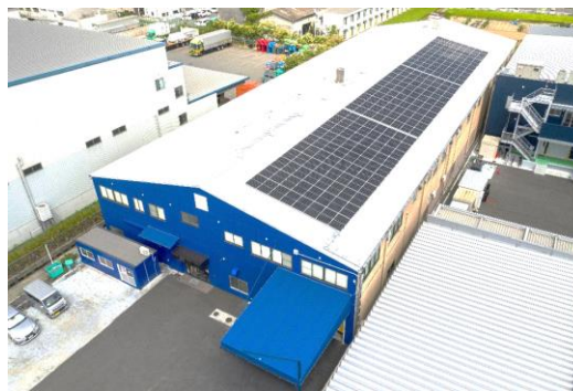
本社の太陽光発電設備
