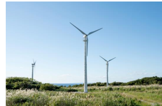
風力発電設備（北海道）
