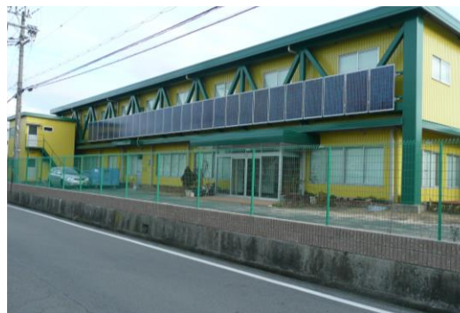
産廃処理工場の自家消費型太陽光発電設備
