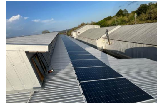
鶏舎屋根の太陽光発電（19kWh）
