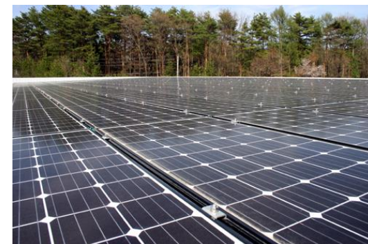
太陽光発電設備
