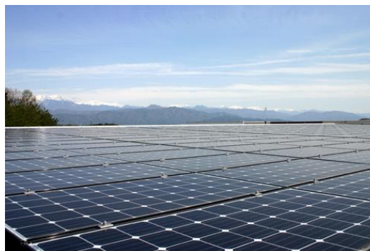
太陽光発電設備
