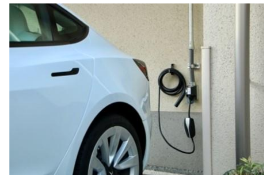
電気自動車用の充電コンセント
