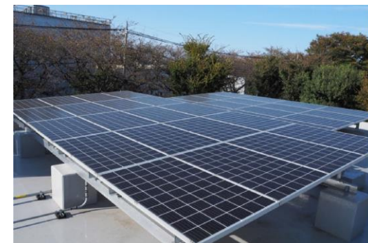
エコゾーンに設置されている 太陽光パネル
