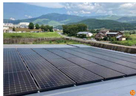
⑥ 株式会社光陽社 太陽光発電設備
